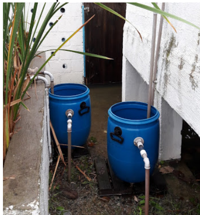
Figura 12 – Recipientes de aferição de vazão afluente dos wetlands construídos.
