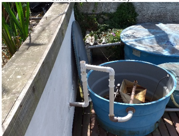
Figura 11 – Anteparo de elevação no nível de saída do wetland construído vertical de fundo saturado (WCV-FS2).
