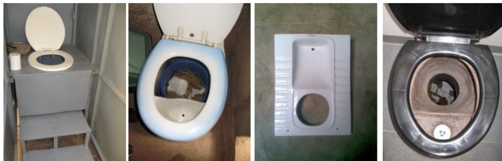
Figura 2: Banheiros secos separadores em áreas rurais
