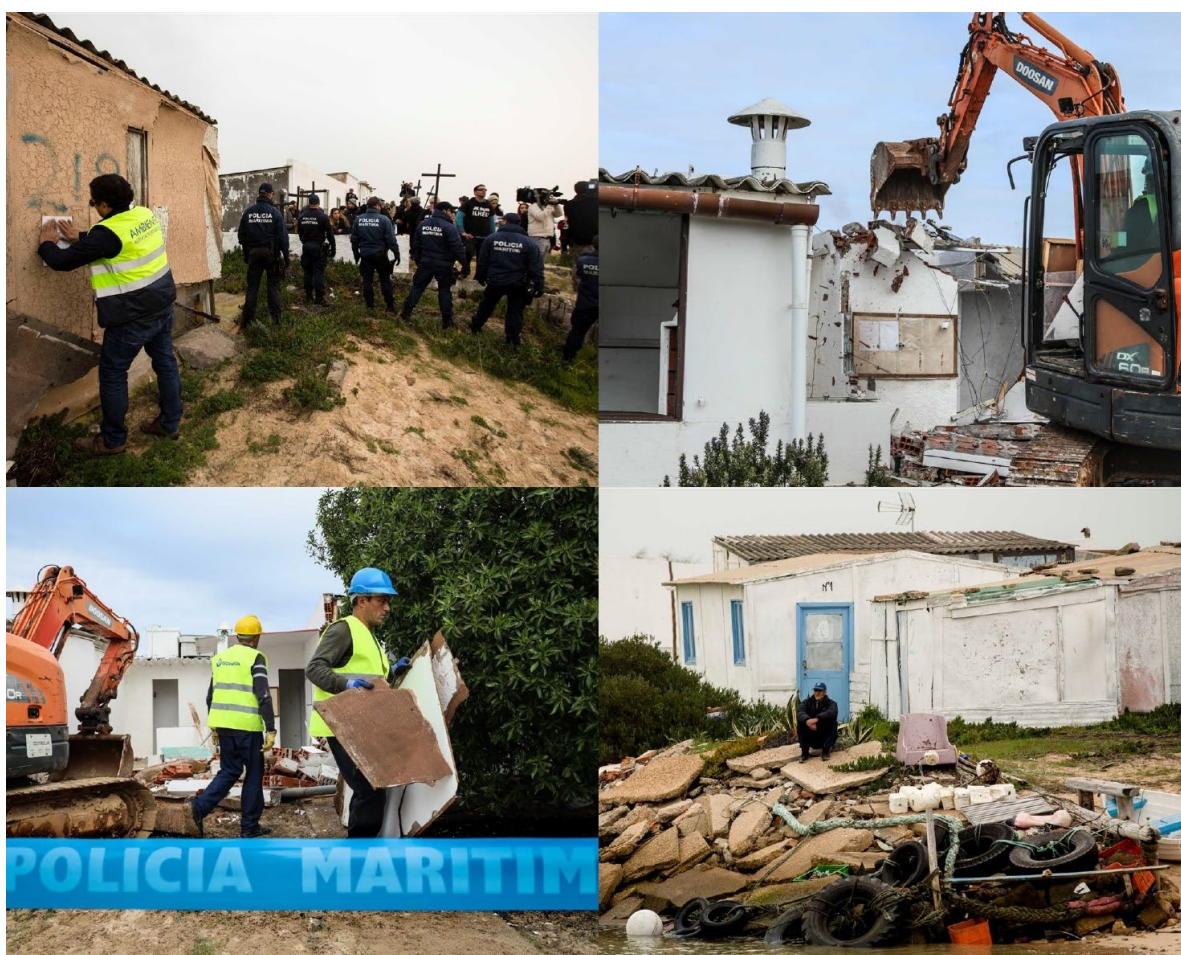
Figura 49: Demolições na Ilha da Culatra. Fonte: Luis Forra/2018 e Filipe Farinha/2017. Diário de Notícias/Lusa.
