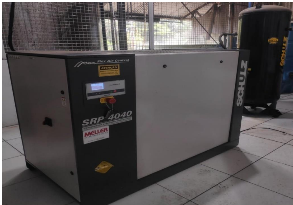
Figura 7: Compressor Schulz 40 Cv com inversor (Novo).
