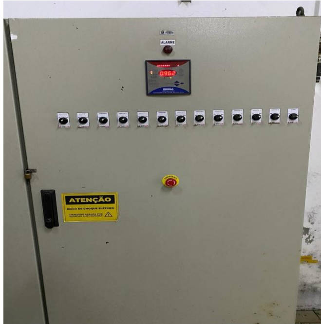
Figura 8: Banco de capacitores.
