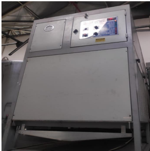
Figura 6: Chiller superior da sala de máquina 1.
