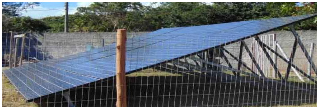
Figura 15: Placas Fotovoltaicas- APAE. Fonte: Autores, 2017.
