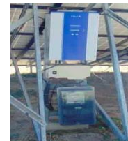
Figura 16: Placas Fotovoltaicas- APAE. Fonte: Autores, 2017.
