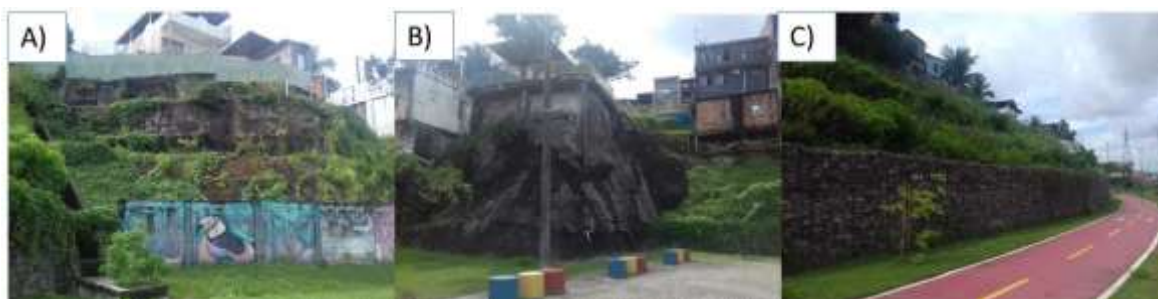
Figura 6: Tipos de contenções utilizadas no Parque Rio Negro em Manaus. A) Muros escalonados; B) Parede Grampeada; C) Muros de Gabião. Fonte: autoras.
