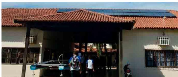
Figura 17: Placa Fotovoltaica instalada no telhado do Colégio Municipal Paulo Freire. Fonte: Autores, 2017.
