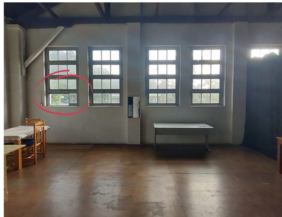
FIGURA 41. GALPÃO DA AJOTE COM ESQUADRIA QUEBRADA. FONTE: ACERVO DA AUTORA.
