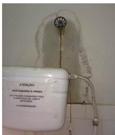
Figura 3: Vazamento do registro de gaveta na Coordenação de Múltiplos. Fonte: elaborado pelos autores.
