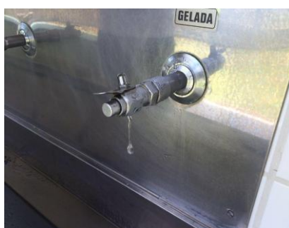
Figura 1: Bebedouro do Bloco de Música apresentando gotejamentos. Fonte: elaborado pelos autores.
