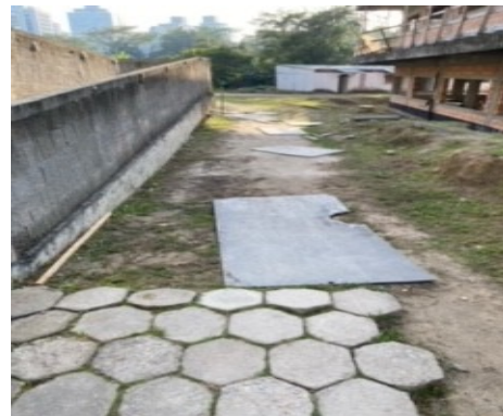
Imagem 4 – Acesso a prédio com término de calçadas
