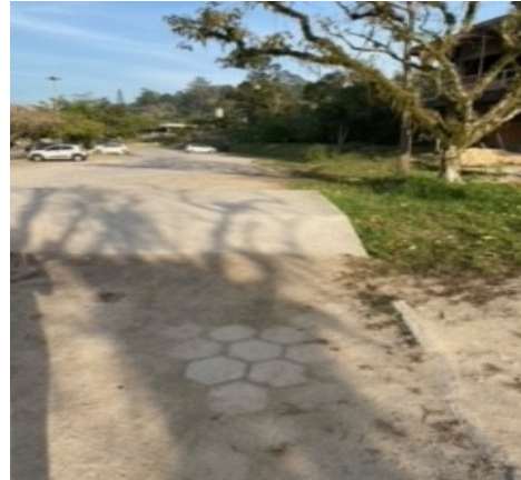
Imagem 2 – Degrau na calçada
