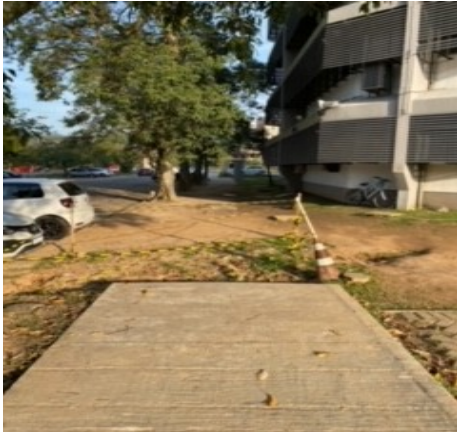
Imagem 1 – Ausência de calçadas
