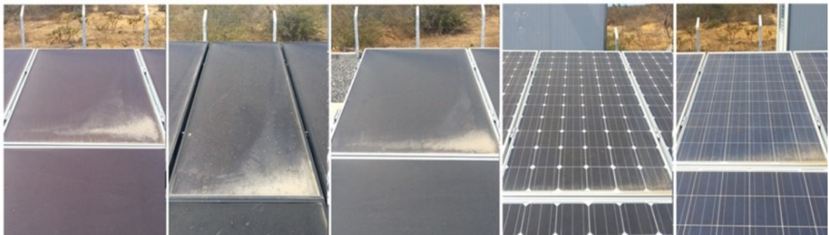
Figura 3.14 (Esquerda) – Perfil não uniforme de distribuição de sujeira em módulos FV causado por forte incidência de ventos. (Direita) – Acúmulo de sujeira nas bordas (edge soiling), causado pela rotação Leste-Oeste de seguidores de 1-eixo. Fonte: (HICKEL et al. , 2016)
