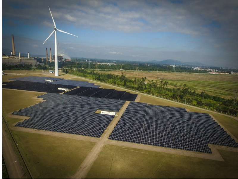
Figura 3.10 - Sistema fotovoltaico fixo composto por tecnologias de silício cristalino e filmes finos, instalado em Tubarão-SC.
