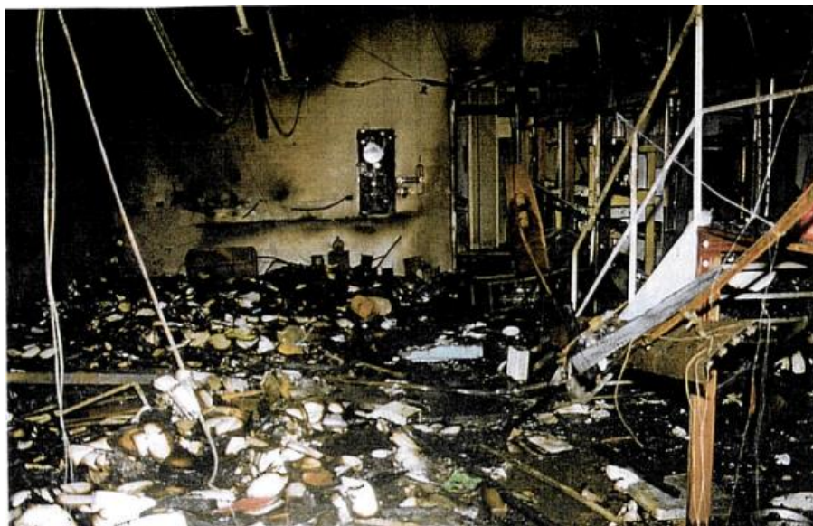
Figura 4- Laboratório de Mecânica dos Solos após o incêndio ocorrido em 1996.
