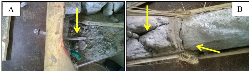
Figuras 13 – Fissura do concreto. Fonte: autores.
