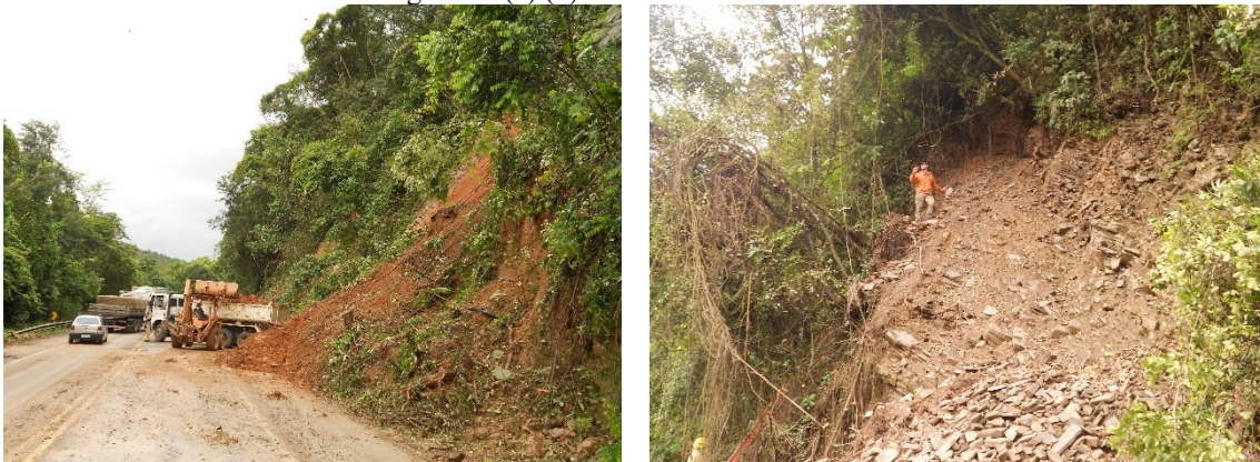
Figura 15 (a) (b)- Deslizamentos ocorridos em 2015
