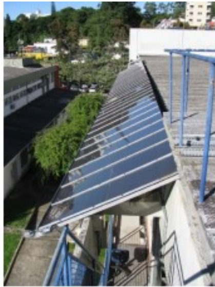
Figura 5: Energia Fotovoltaica – Centro de Cultura e Eventos e prédio da Eng. Mecânica
