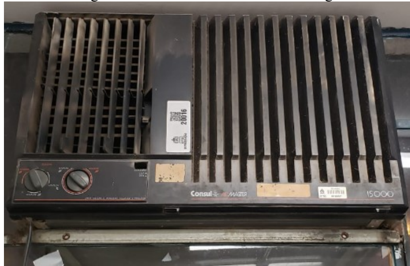
Figura 11: Ar-condicionado Janela antigo
