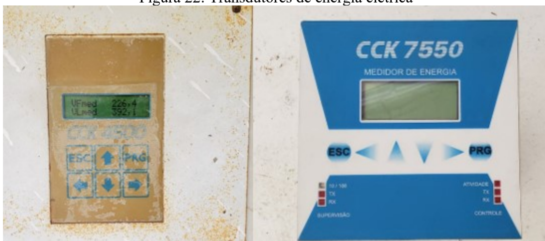
Figura 22: Transdutores de energia elétrica
