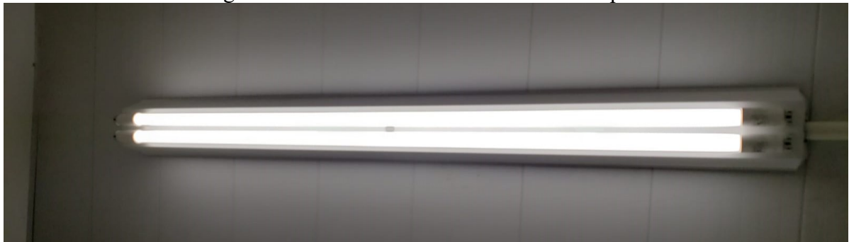
Figura 17: Luminária instalada em calha simples
