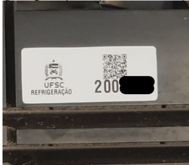
Figura 10: QR Code para acompanhamento das manutenções
