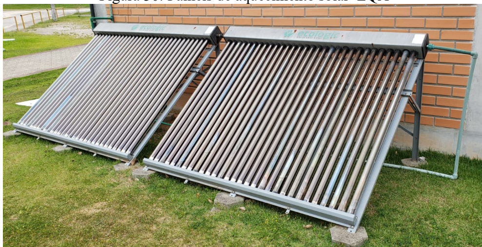
Figura 30: Painéis de aquecimento solar EQA
