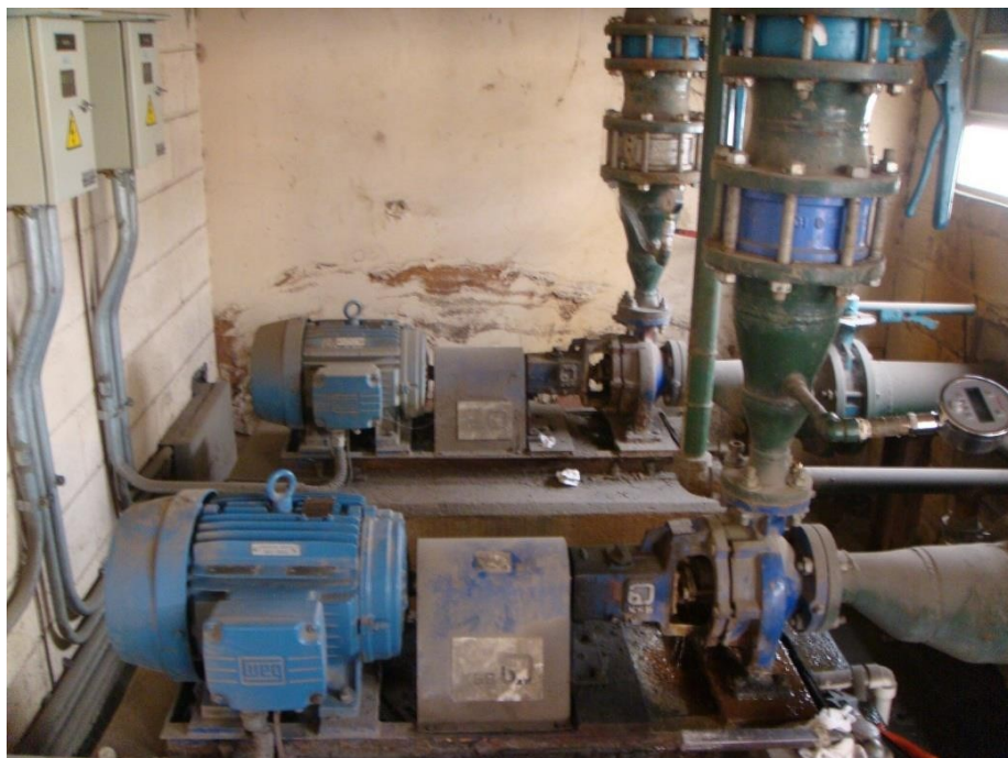
Figura 3 – Fotografia parcial das bombas da ETA
