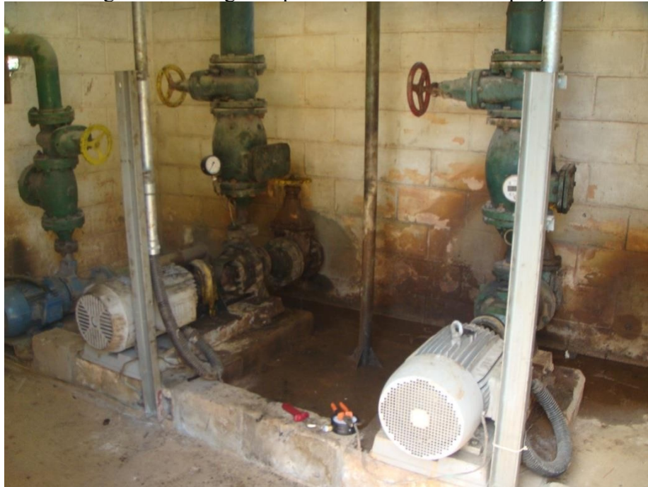
Figura 2 – Fotografia parcial das bombas de captação
