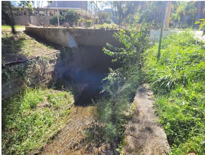
Figura 17 - Canal assoreado com presença de vegetação
