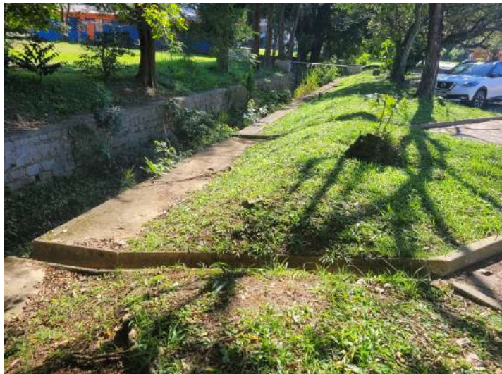
Figura 16 - Drenagem de Estacionamento dentro da UFSC
