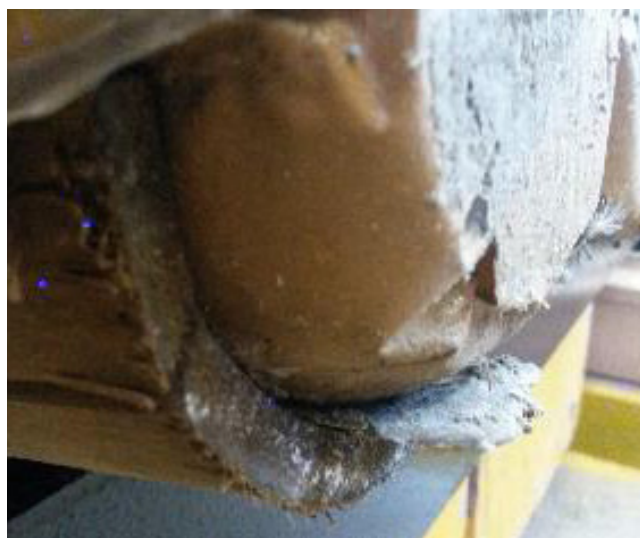
Figura 14 – Deslizamento da massa de concreto no apoio.
