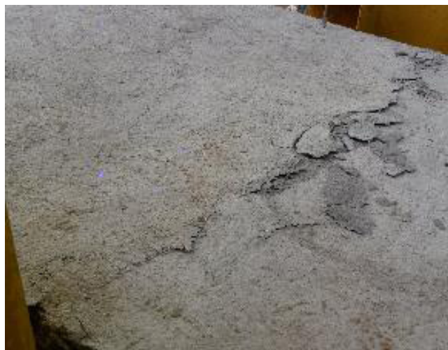
Figura 13 – Ruptura da capa de concreto.
