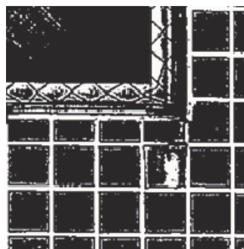
Figura 14 – Imagem da manifestação patológica binarizada: presença de eflorescência na fachada Sul Fonte: Autores
