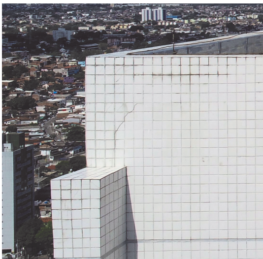
Figura 09 – Presença de trinca na fachada Oeste Fonte: Autores
