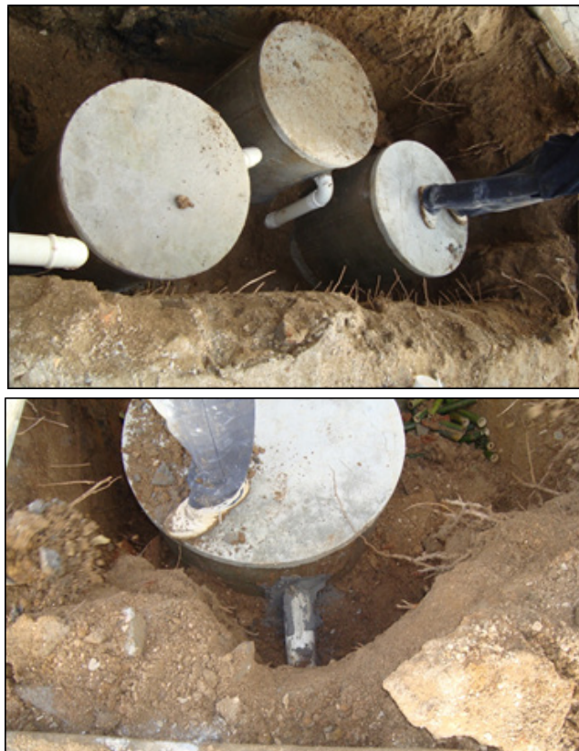
Figura 6 – (a) Execução concluída; (b) Ligação do tratamento até a drenagem da rua. Fonte: Autores (2016).
