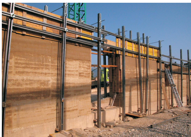
Figura 04 - Cofragem com correias para fabricação de paredes em taipa de pilão. Fonte: Fonte Hidalgo (2011)
