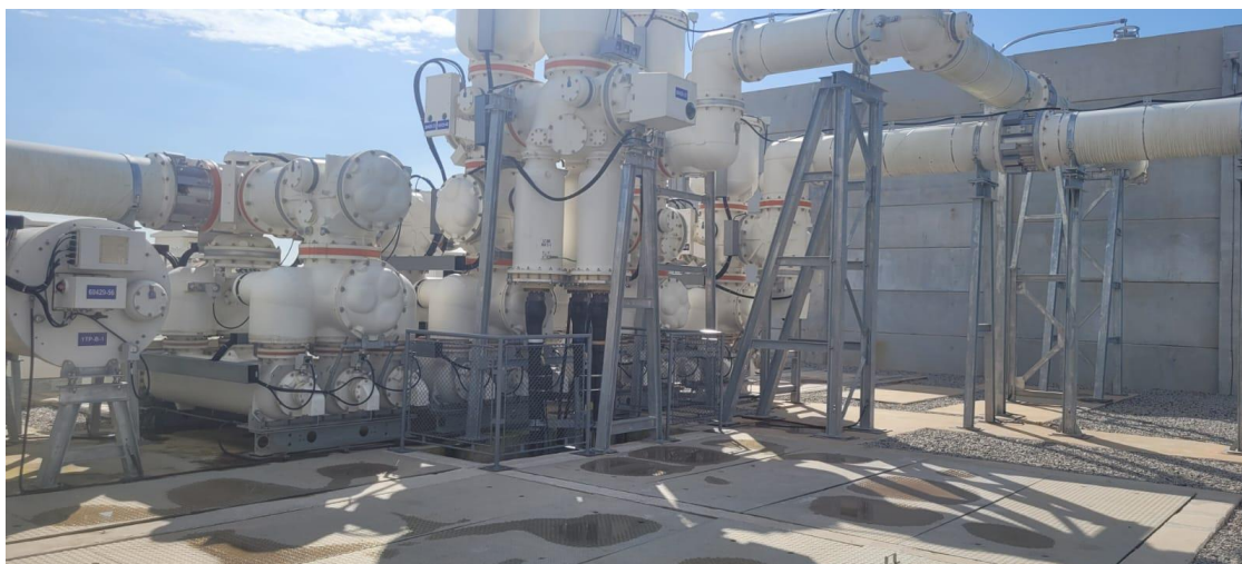
Figura 46 - Bay de uma das linhas de 230 kV da SE Ratonés
