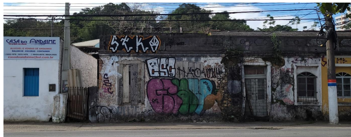
Figura 3 – Casa em Ruínas no Bairro Saco dos Limões. Fonte: Os autores, 2022.
