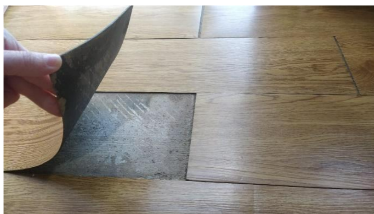
Figura 7: Descolamento do piso de PVC. Fonte: elaborado pelos autores.
