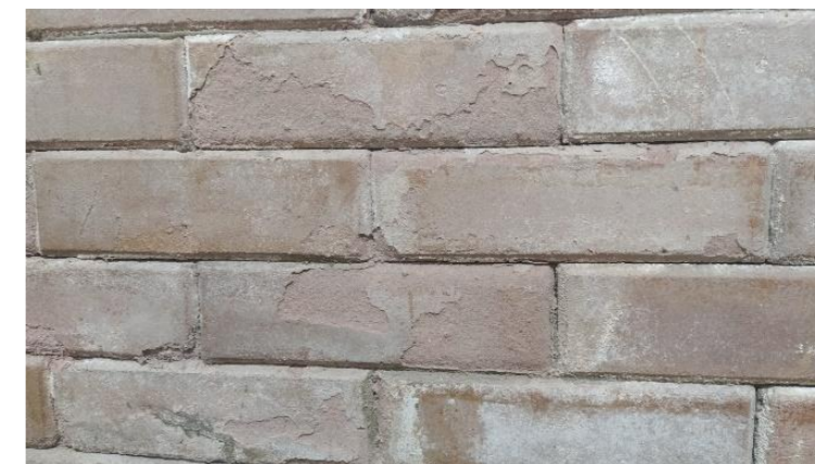
Figura 8: Parede interna com sinais de degradação. Fonte: elaborado pelos autores.
