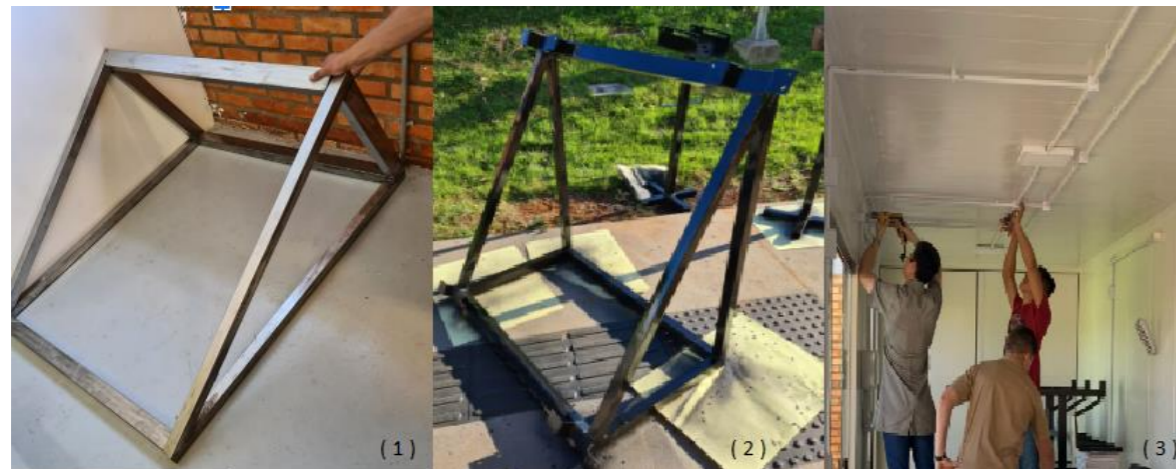
Figura 1: (1) - Estrutura de suporte dos painéis, (2) - Pintura da estrutura de suporte e (3) - instalação elétrica. Fonte: elaborado pelos autores.
