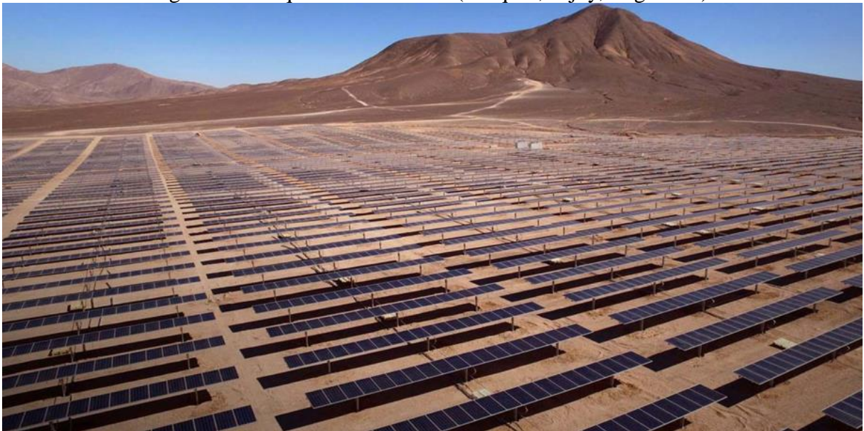
Figura 1 – Parque solar Caucharí (Susques, Jujuy, Argentina).
