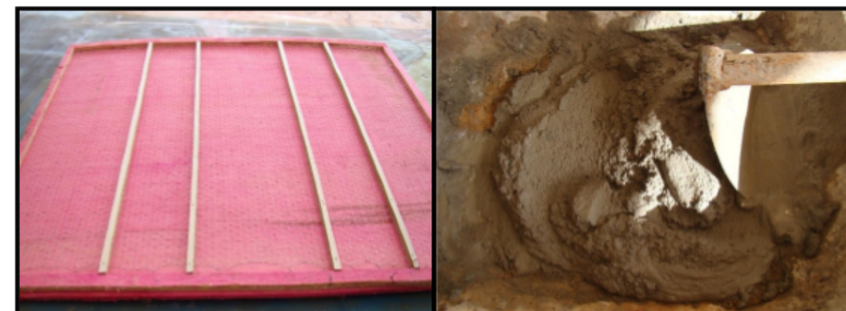
Figura 8.a: Molde da proposta de escada em argamassa armada com partículas de pneus como agregado leve. Fonte: Rodrigues, 2008.
