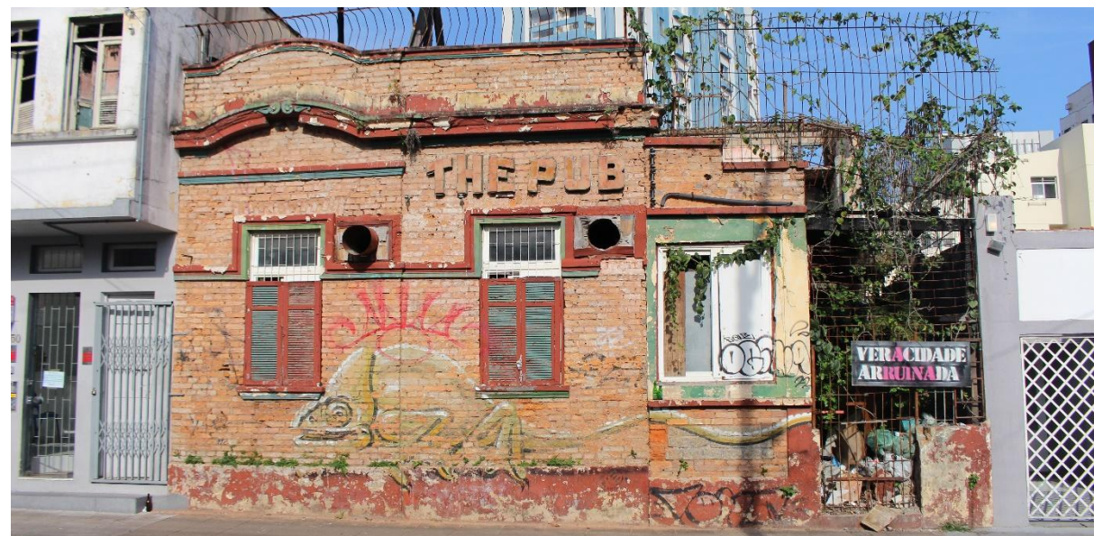
Figura 4 – Edificação abandonada na Rua Anita Garibaldi. Fonte: Os autores, 2022.
