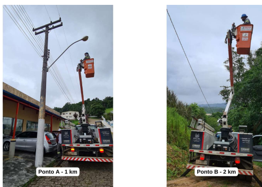
Figura 19 – Testes realizados em campo em Urussanga na rede EFLUL
