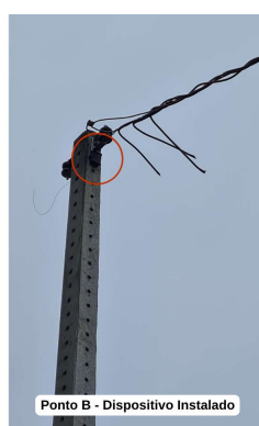
Figura 20 – Dispositivo instalado na rede da EFLUL
