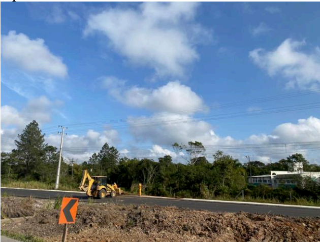
Figura 26 - Obras de duplicação da BR-280, lado oposto a entrada do Instituto Federal Catarinense.
