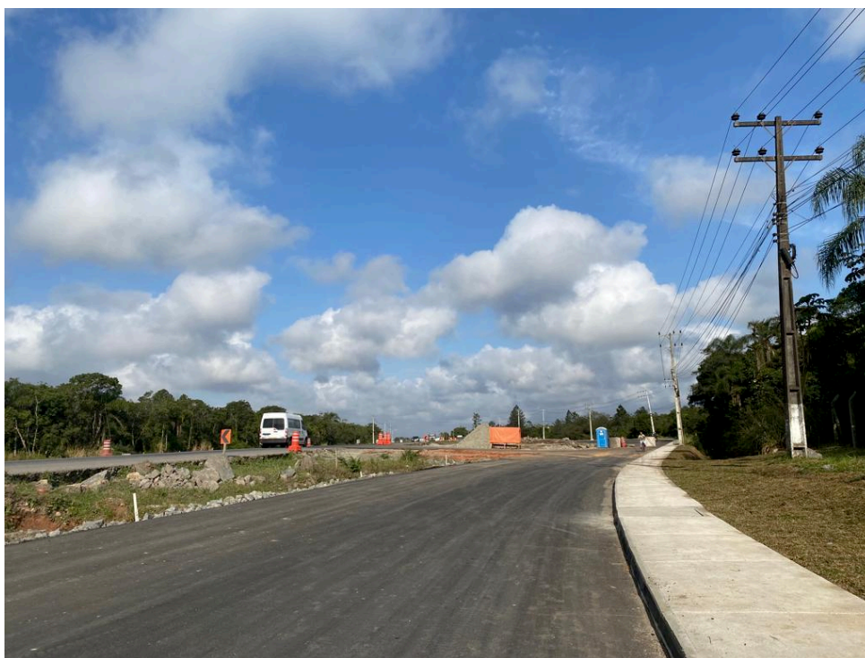
Figura 40 - Obras de duplicação da rodovia BR-280 no lado oposto a sede do Instituto Federal Catarinense
