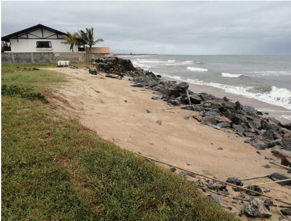
Figura 10 - Enrocamento na no município de Barra Velha, o qual caracteriza uma redução da faixa de areia a ser ocupada
