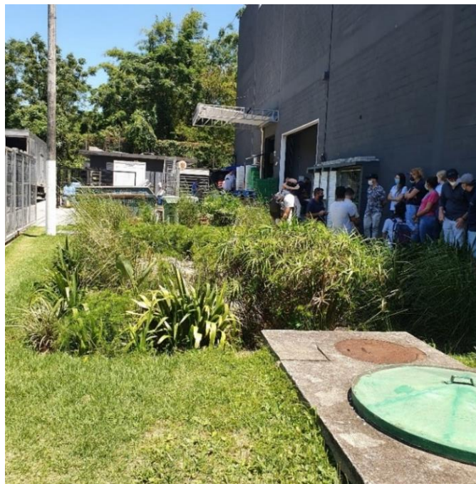
Figura 11 - WCV como tratamento secundário de esgoto sanitário gerado em prédio comercial localizado em Florianópolis/SC.
