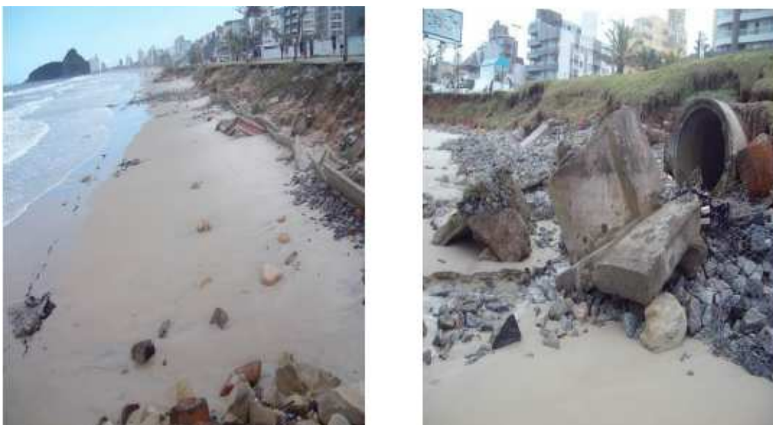
Figuras 24 e 25 - Processo avançado de erosão costeira na Praia Brava de Matinhos
