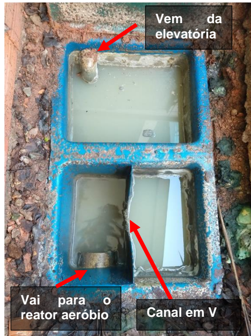
Figura 32 – Medidor de vazão Thompson
