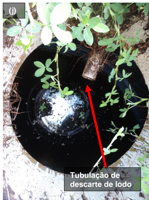
Figura 40 – Tanque de acúmulo
