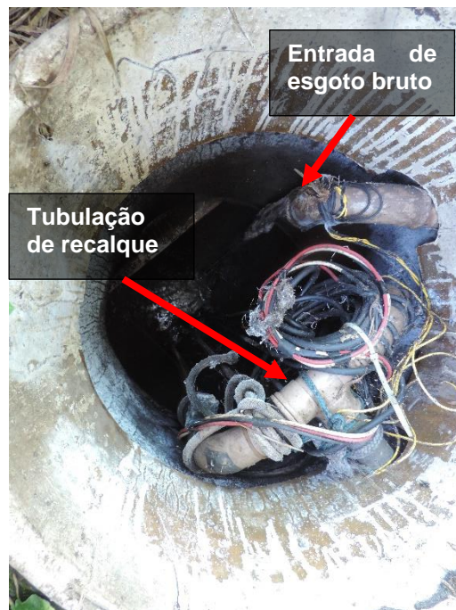
Figura 30 – Elevatória de esgoto bruto
