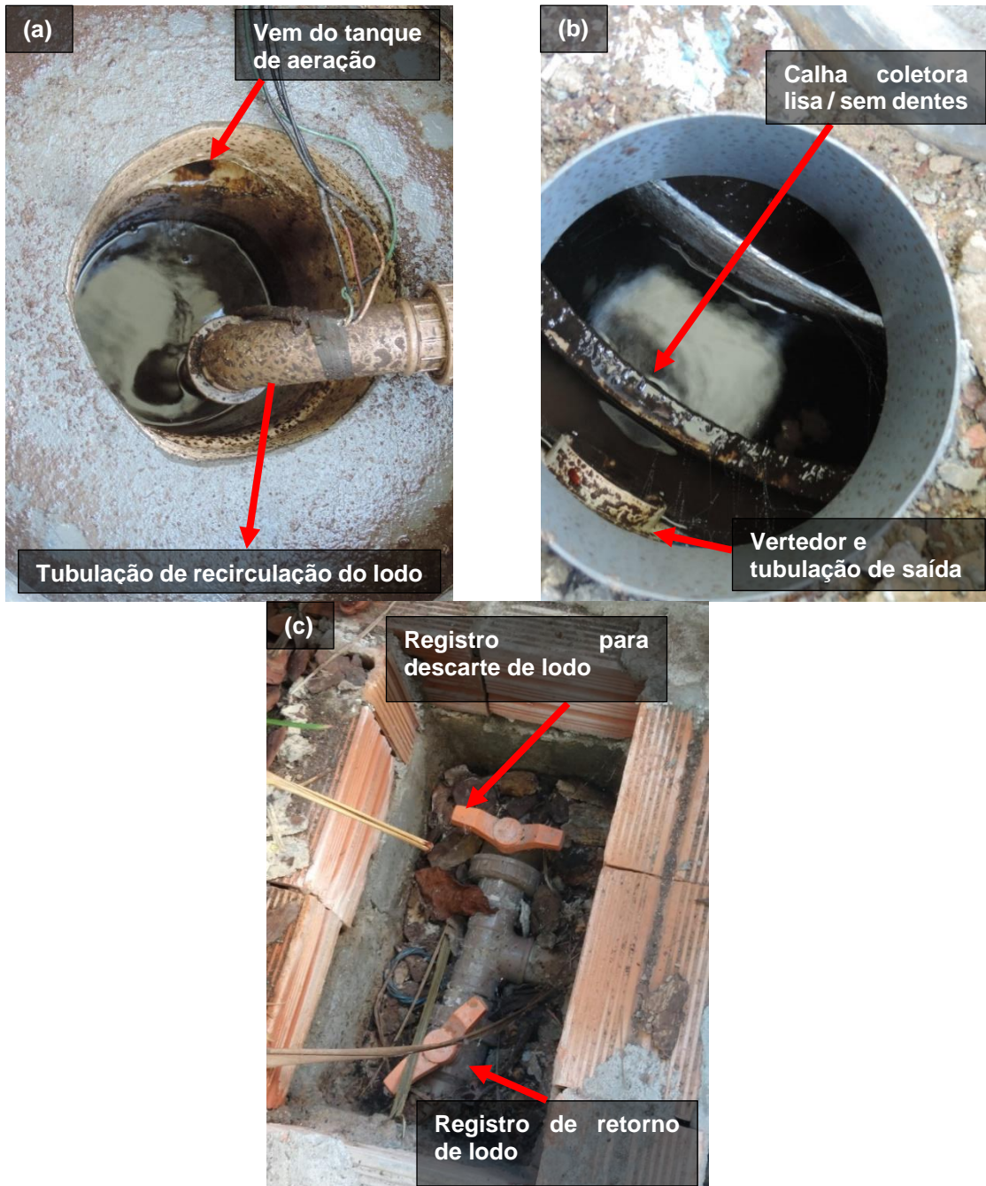
Figura 36 – (a) Decantador, acesso 1; (b) decantador, acesso 2; e (c) registros da recirculação e retorno do lodo
