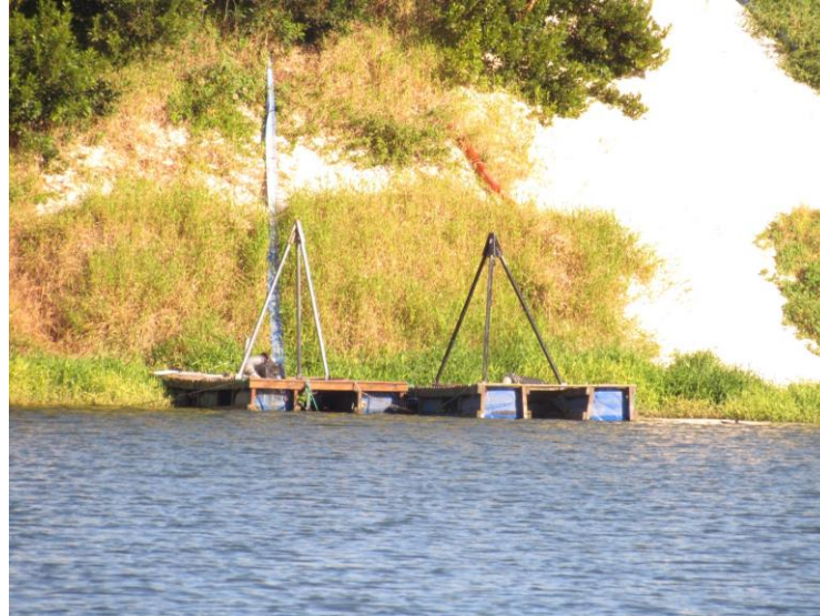
Figura 31. Estrutura responsável pelo bombeamento emergencial do excedente de água da LEI da ETE Lagoa da Conceição
