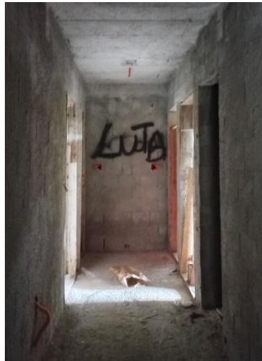
Figura 13 – Pichação do movimento no prédio ocupado
