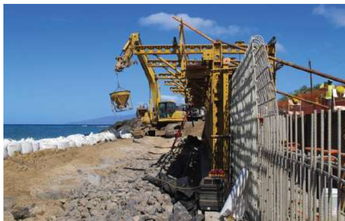
Figura 7 - Muro de contenção em área marítima com armadura em GFRP Fonte: ACI 440.1R (2015)
