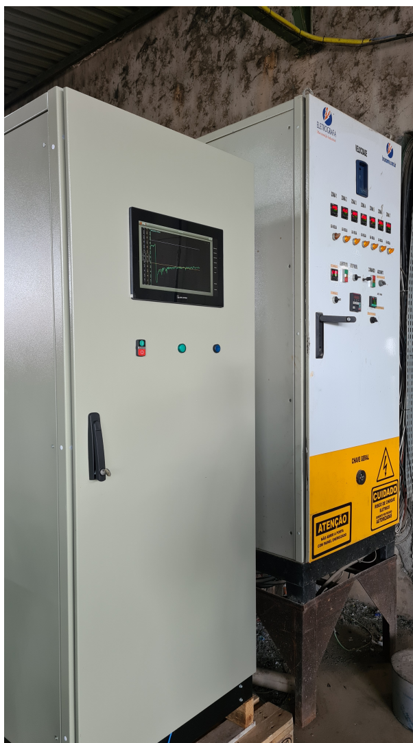
Figura 21 – Registro do painel de controle em operação ao lado do painel de acionamento existente na empresa.
