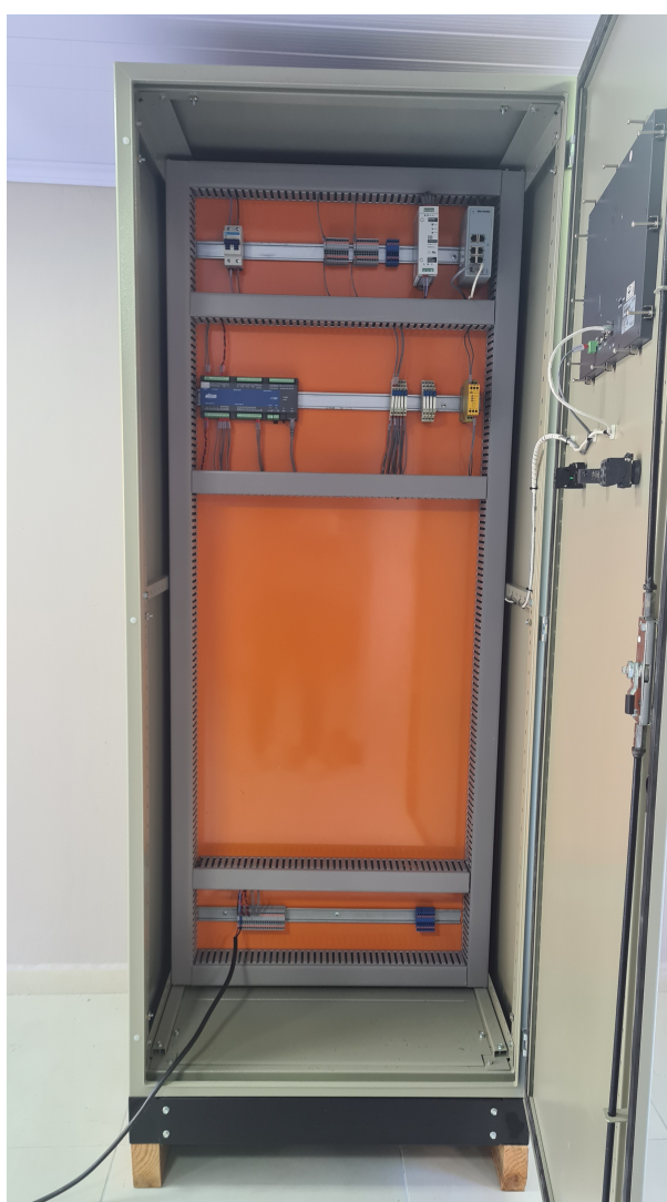
Figura 17 – Registro da vista interna do painel de controle.
