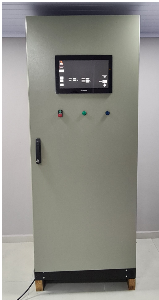
Figura 18 – Registro da vista externa do painel de controle.
