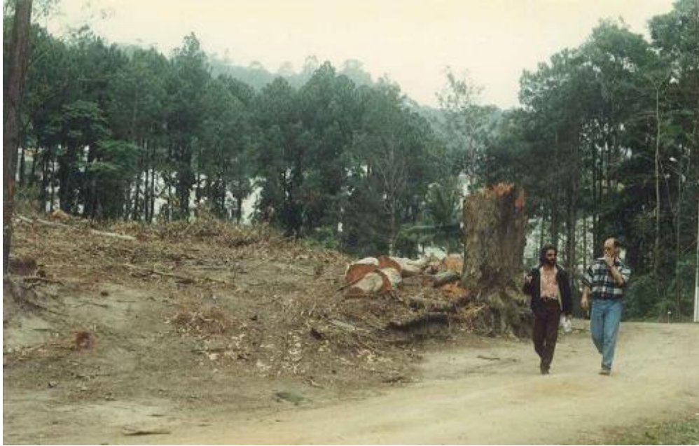
Fig. 07 – Situação da área após derrubada parcial dos pinus e eucaliptos Fonte: Pau-Campeche, 1996, apud Góes, 2011.
