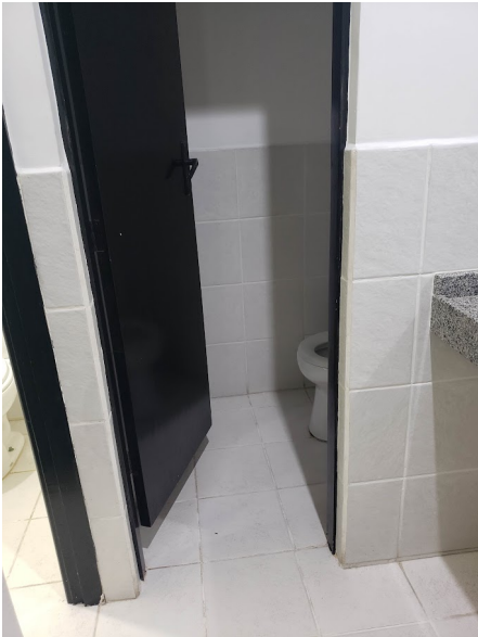
30 - Vão de acesso a banheiro Memorial Orlando Scarpelli Imagem
