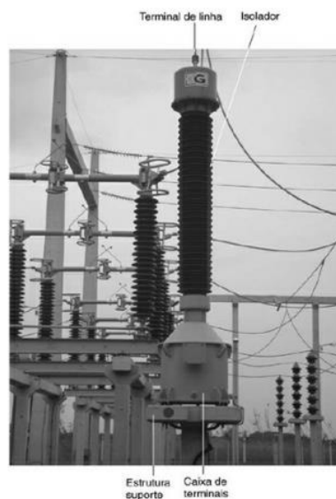
Figura 6. Transformador de potencial (TP)
