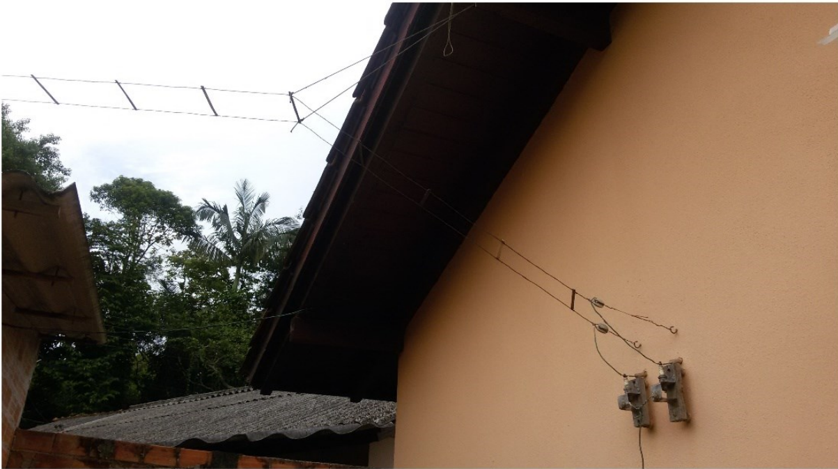
Figura 20- Fotografias da linha de transmissão. De cima para baixo: Ponto de saída da sala de rádio, linha passando sobre a edícula.
