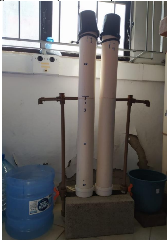
Figura 5 - Instalação dos filtros pilotos no LAPOÁ
