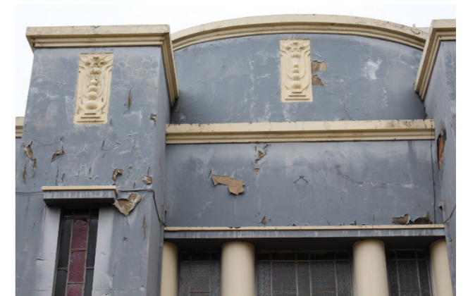
Figura 129: patologia do concreto. Fonte: acervo pessoal, 2022.
