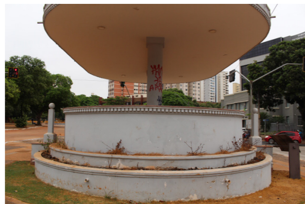
Figura 103: pichagem no pilar de sustentação. Fonte: acervo pessoal, 2022.
