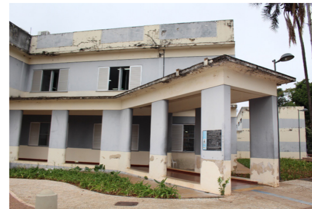
Figura 114: patologias do concreto. Fonte: acervo pessoal, 2022.
