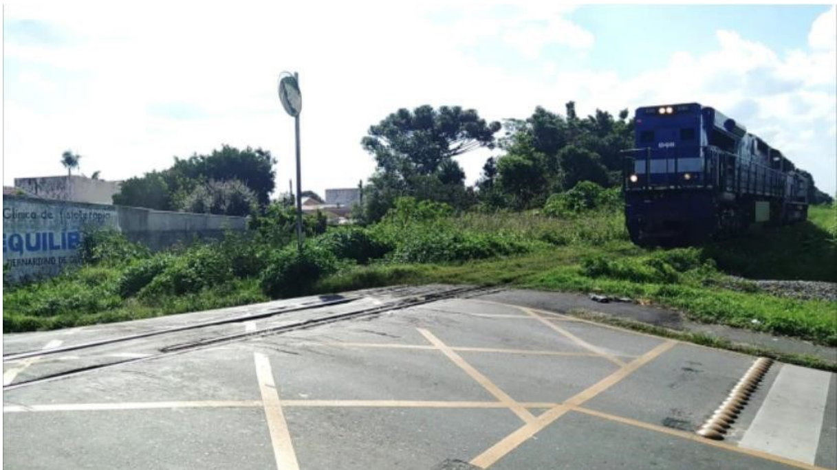
Figura 21 - Passagem em nível no bairro Cajuru em Curitiba sem barreiras de segurança
