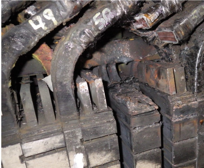
Figura 16 – Estator de um gerador síncrono hidráulico com dano no núcleo.
