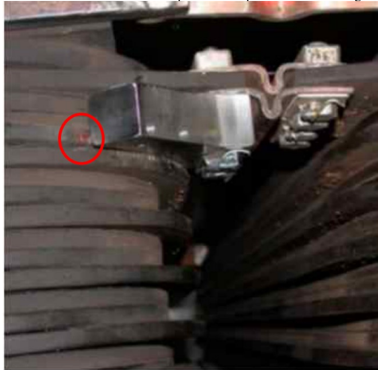
Figura 8 – Ocorrência de um curto-circuito de espiras em um polo do rotor de um gerador de 330 MVA.
