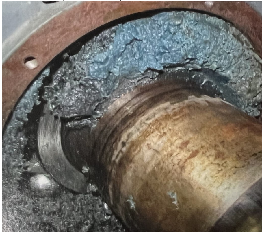
Figura 9 – Lubrificação excessiva no rolamento I.
