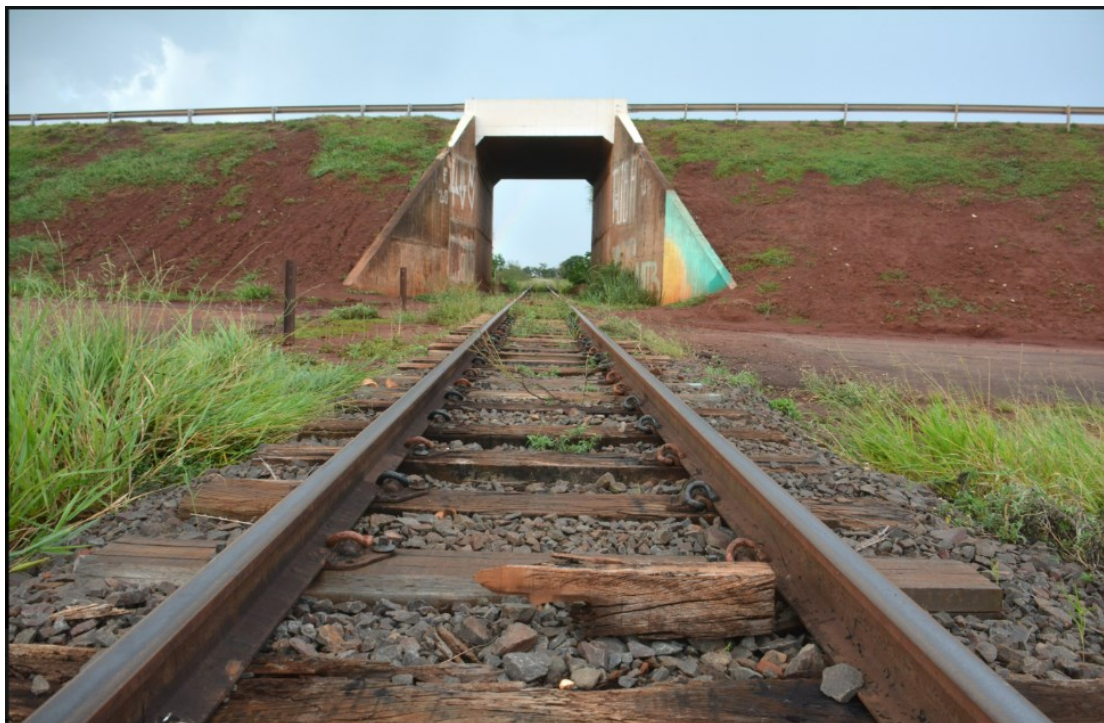
Figura 21 - Malha Oeste, antiga Noroeste do Brasil, necessita de reparos
