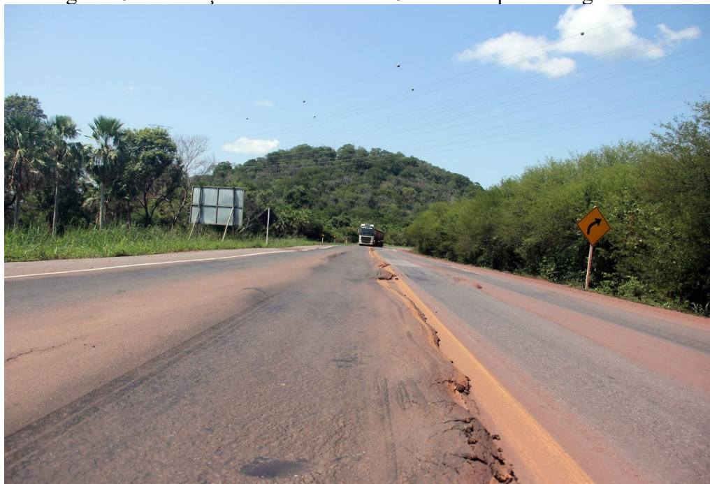
Figura 19 - Condição da rodovia BR-262 causada pelo tráfego intenso
