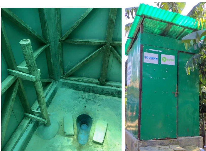
Figura 36: Interior latrina Oxfam.
