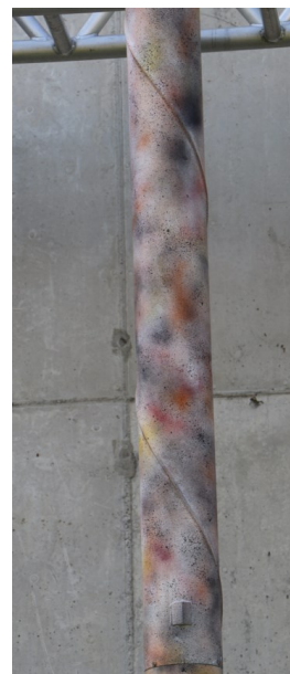
(b) Trecho defeito helicoidal.
