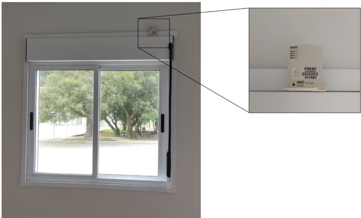
Figura 21 - Instalação em campo dos sensores de temperatura
