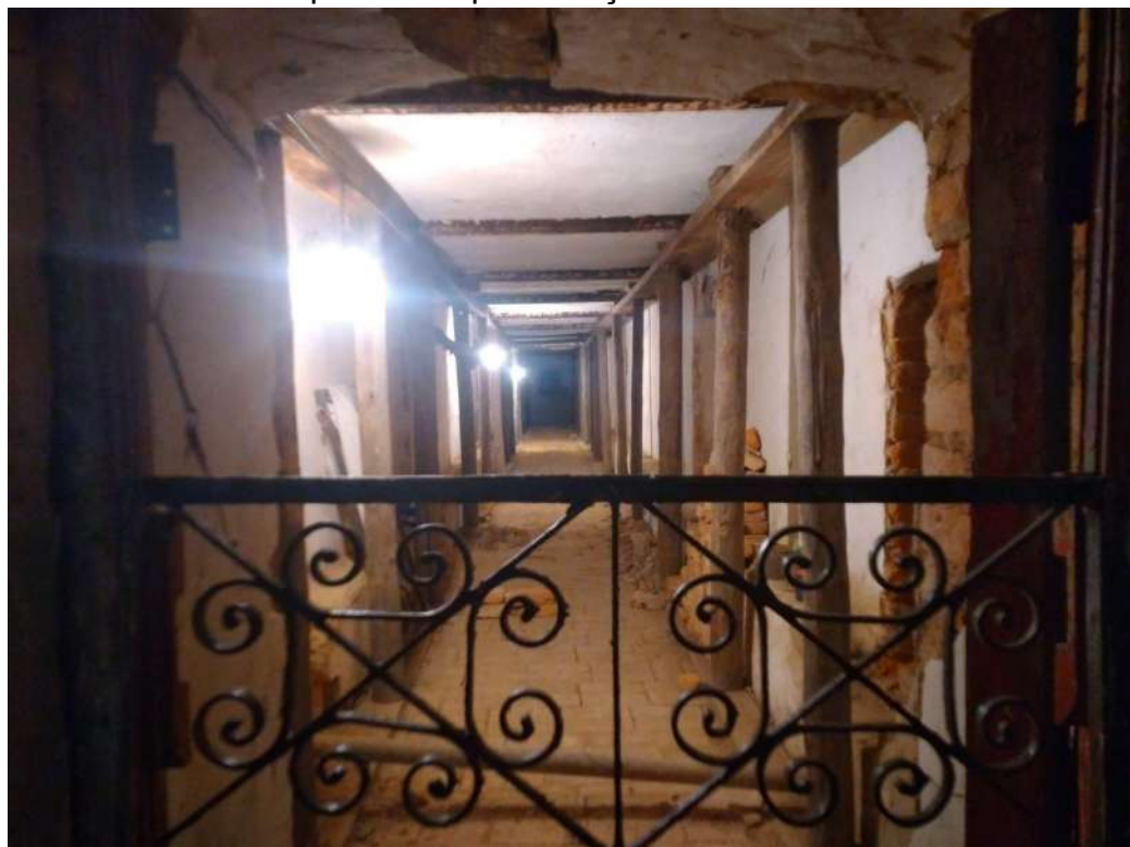
Figura 11 – Futuro Espaço Museal do Espaço Comum Luiz Estrela, no momento passando por reforços estruturais.
