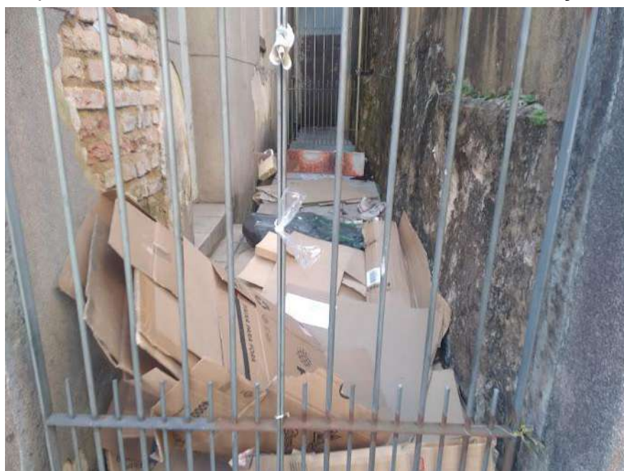
Figura 55 – Edificação na Rua Padre Roma, número 173-189, considerada ociosa e que denota o acúmulo de materiais dentro da edificação.
