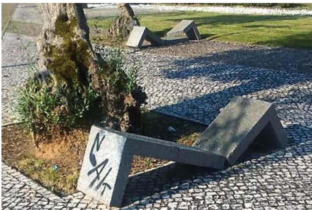
Figura 7 - Mobiliário quebrado e vandalizado
