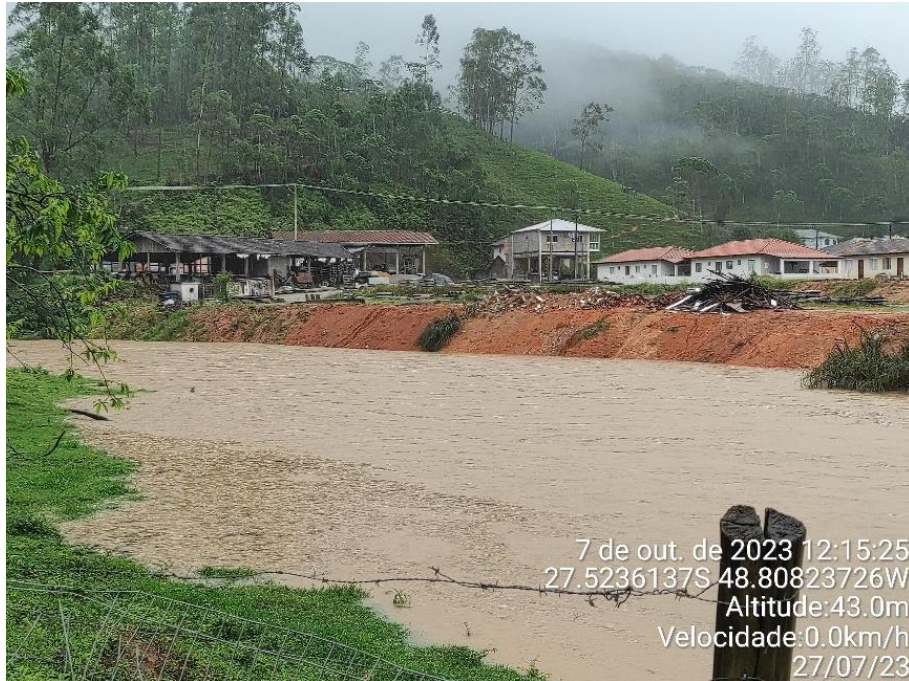
Figura 37 – Solo exposto suscetibilidade a erosão no trecho em estudo, na estaca 45+0
