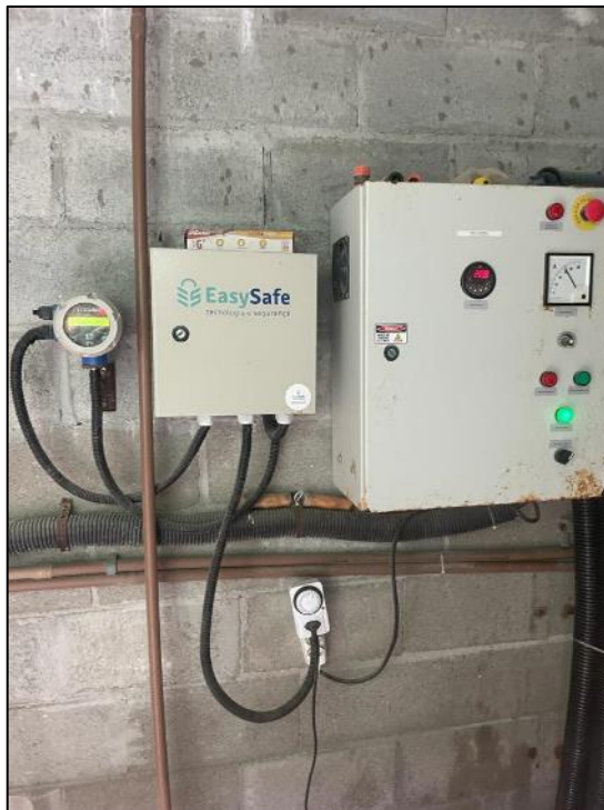
Figura 28 – Sistema de telemetria – ETE SAE Pedra Branca.
